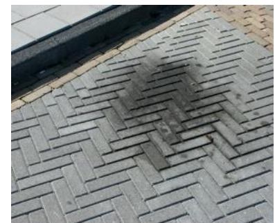
Vervuiling door olie lekkages
