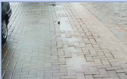
Figuur 1.6 Schade ten gevolge van pompeffect
